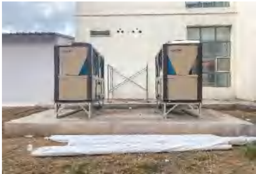
图12 改造后辅助热源采用空气源热泵系统
