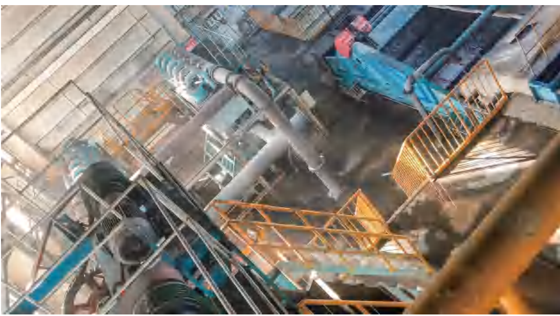
图5 布置合理紧凑的厂房内部
