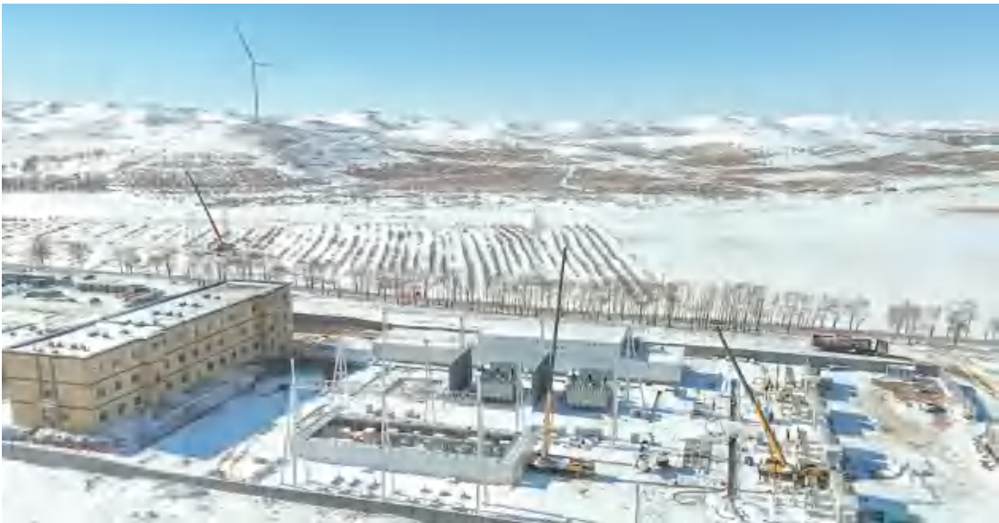
图5 实景—升压站部分
