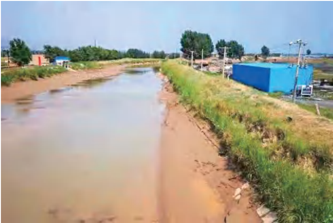
图3 总干渠0+000-6+300段渠道预制混凝土板破坏严重
