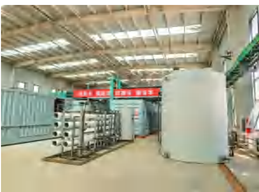
图5 高盐水处理设施
