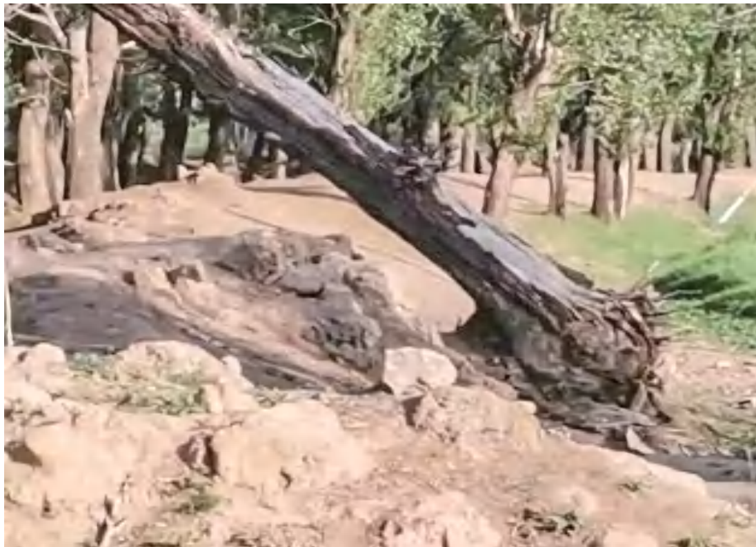
图4 哈素海—扬干渠 10+405-13+747段树木丛生、过流能力不足
