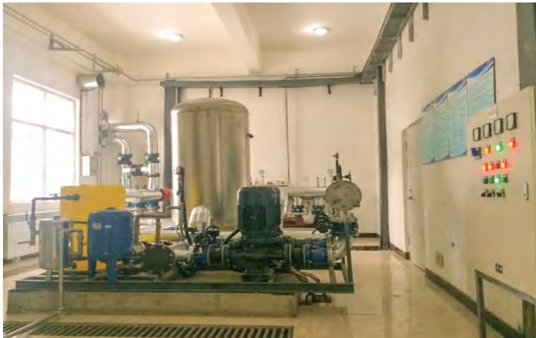
循环系统及储热水罐
