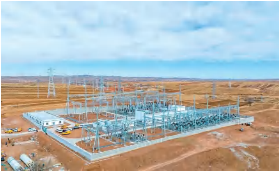
呼和浩特红泉220kV变电站投产运行
