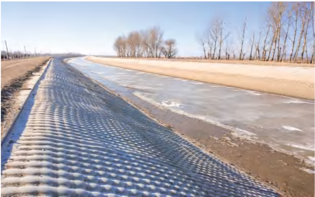
图10 镫口灌区膜袋混凝土衬砌
